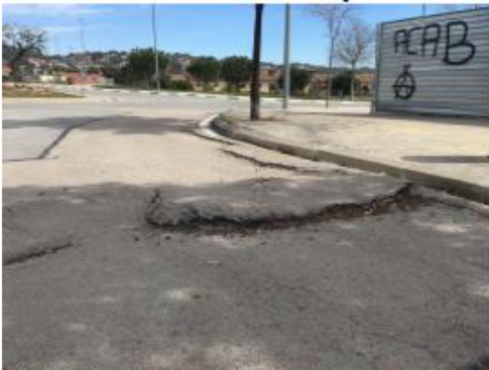
FOTO16: Abombaments molt greus a calçada i desperfectes a vorera
